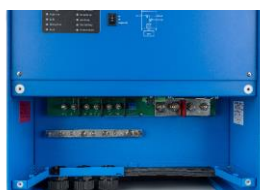
Zona de conectare MultiPlus 20k
